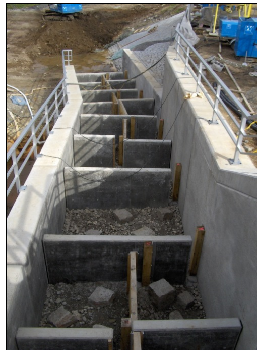
Wanderhilfe als Schlitzpass im Bau am Wehrstandort Agrarpark Leipzig, Thüringen (Foto: Stadt Hamm)
